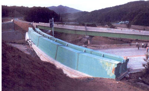
그림 3-13 신동IC RAMP A-2교 낙교 전경
