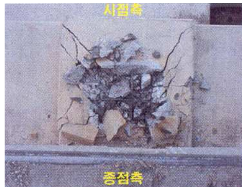
(b) 받침 콘크리트 파괴면
