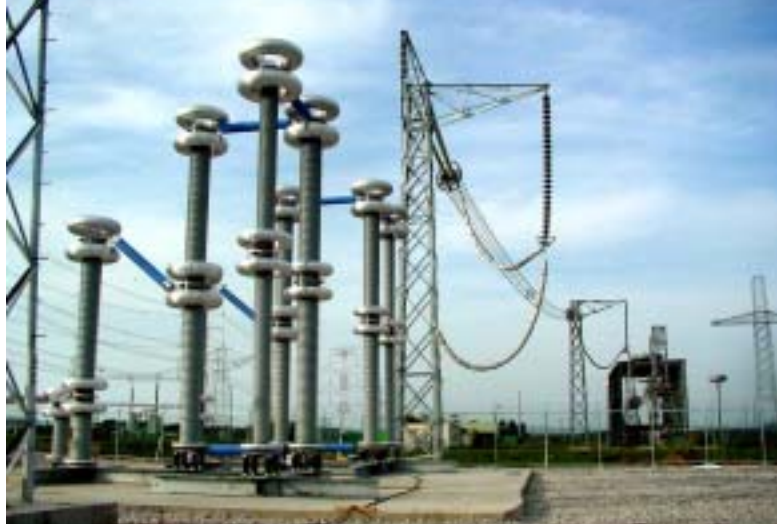
그림 4.8 코로나 케이지에 설치된 HVDC 전원설비
