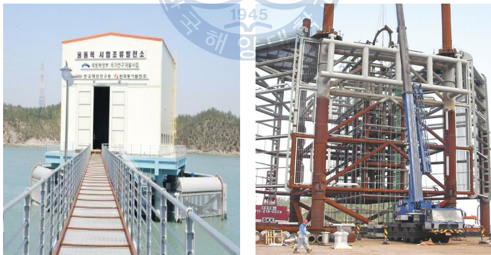
Fig. 2.2.1 1MW VAT helical tidal power
