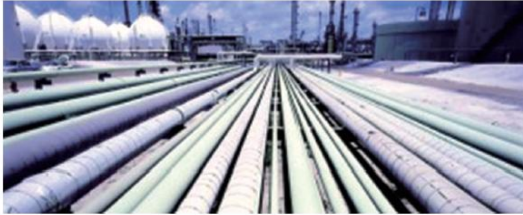
<그림 3-6> LNG 배관의 외관
