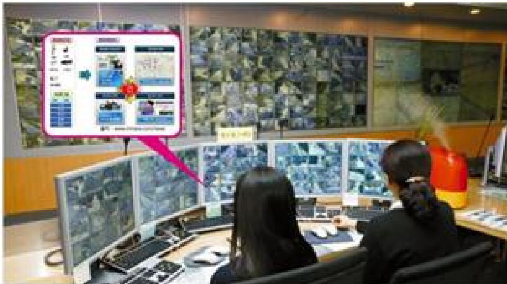
그림 1.1 지능형 CCTV 시스템 Fig. 1.1 Intelligent CCTV system
